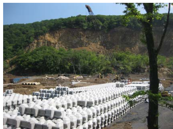
復興工事最中の先の地震の崩落地
